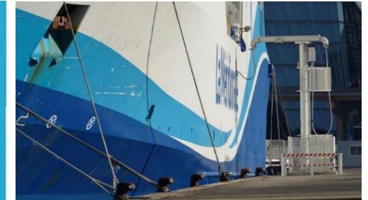
Connexion à quai
